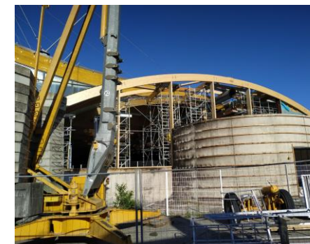
Intervention suite à un incendie
