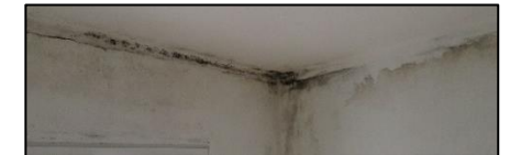
Cas de développement de moisissures
