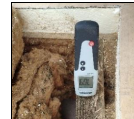
Présence d'humidité forte dans un caisson
